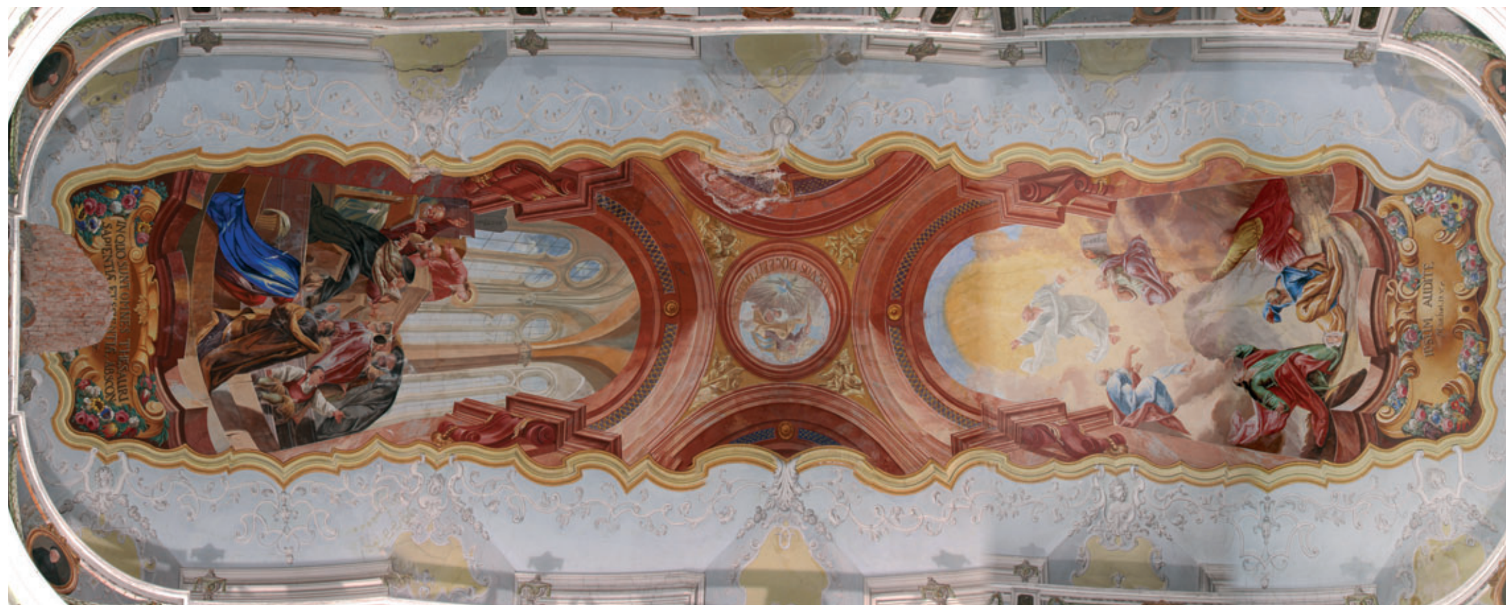
Obr. 8 – Freska na stropě knihovniho sálu. Stav před rekonstrukcí. Foto: Jakub Šleis.
